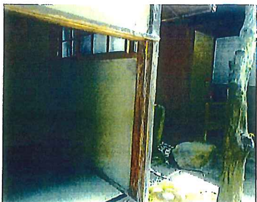
(金毛窟土壁破損箇所工事前)
