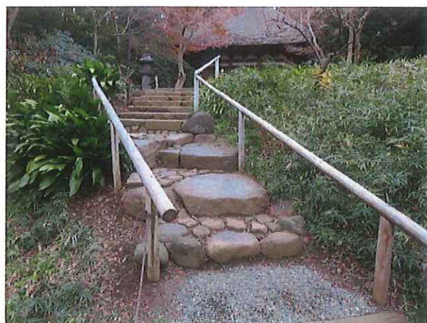
内苑石段手摺り（修理前）
