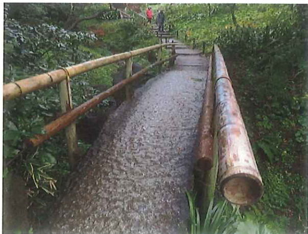
内苑石橋手摺り（修理前）
