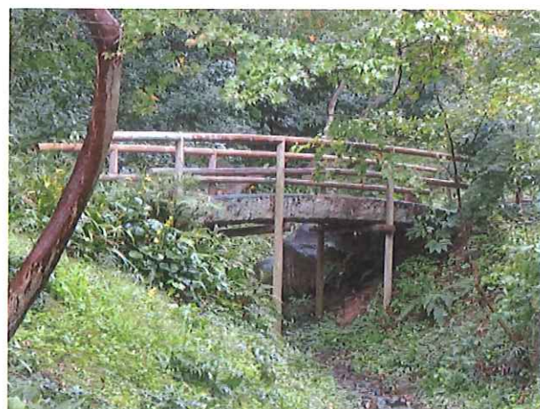
内苑石橋手摺り（修理前）
